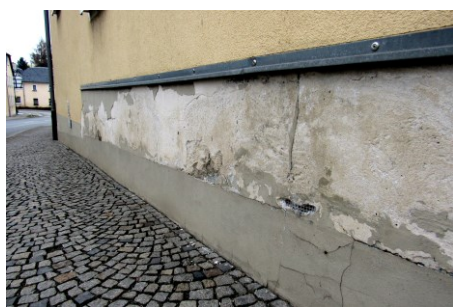
Schäden am Sockel des Pfarrhauses
